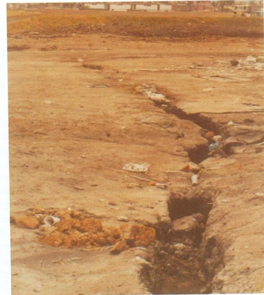
Grietas en la zona de transición de la Calz. I. Zaragoza hacia la Sierra de Santa Catarina
